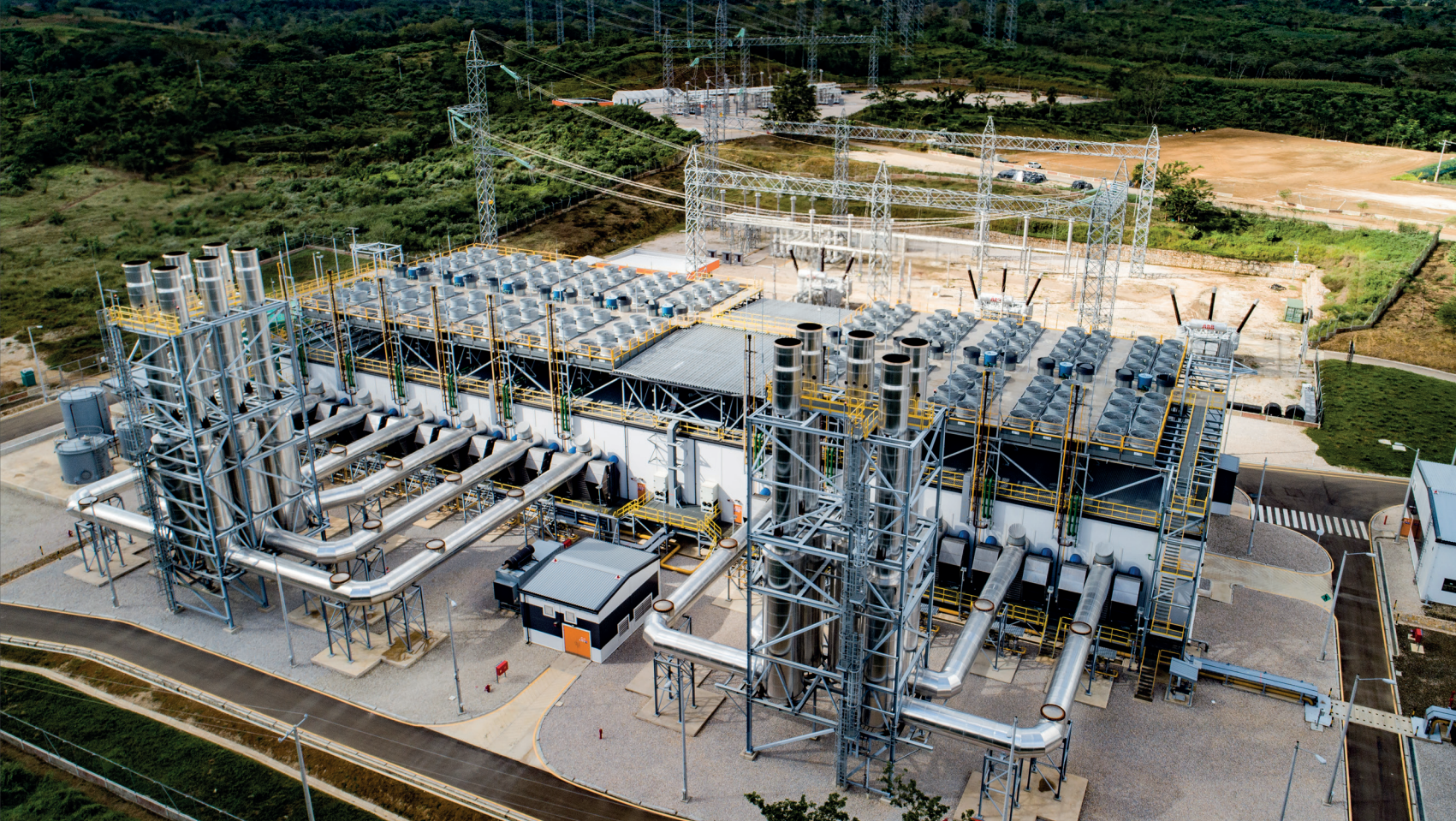
Termoelectrica El Tesorito, Sahagún, Córdoba.
